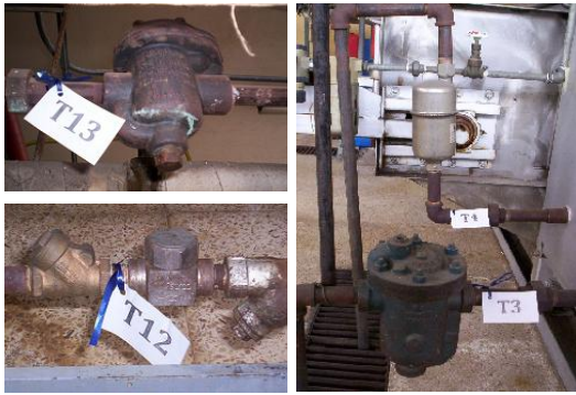
Figura 11. Identificación en sitio de trampas de vapor.
